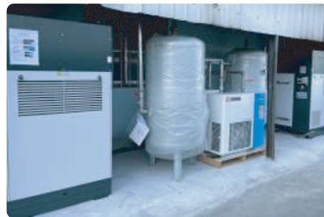
伺服節能空壓機 (2023.12.29安裝完成)
